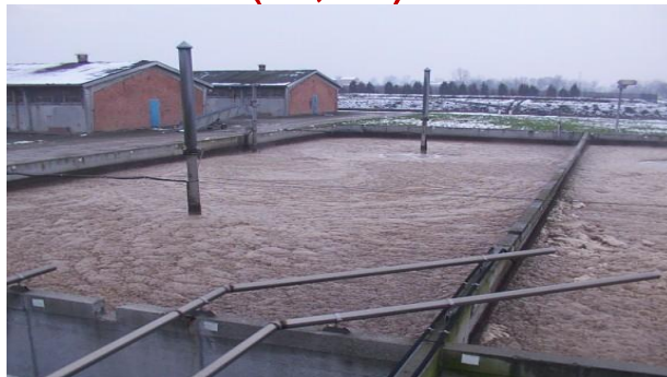
Impianto SBR c/o Allevamento S. Anna (MO)
