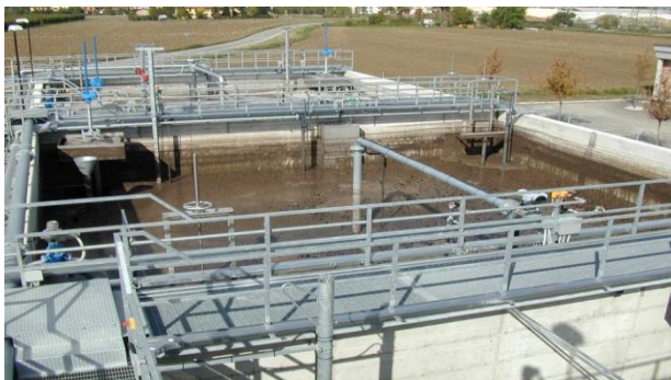
Impianto SBR di Funo di Argelato (BO)
